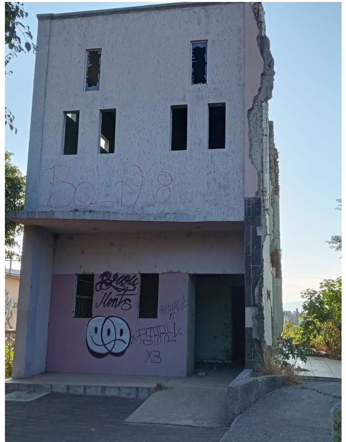
Figura 6. Daños estructurales por subsidencia visibles en 2025 en el antiguo edificio del COMAPA, Fraccionamiento Valle Real.
