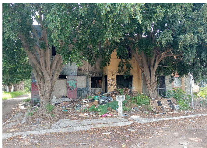
Figura 3. Daños estructurales internos por subsidencia en 2025 en viviendas, Fraccionamiento Campestre.
