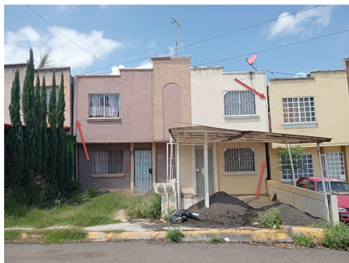
Figura 2. Daños estructurales por subsidencia visibles en 2025 en viviendas, Fraccionamiento Laureles.
