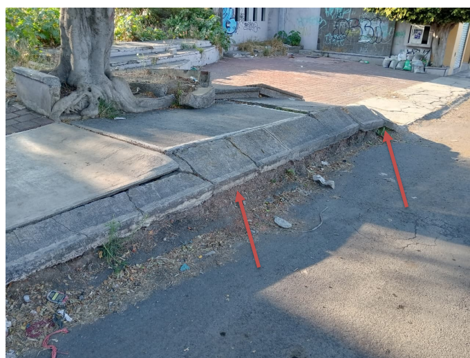
Figura 4. Subsidencia visible en 2025, sobre calle Paseo Valle Real, Fraccionamiento Valle Real.
