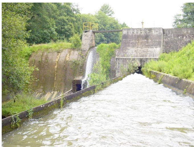
Figura 1. Presa y canalización de las aguas del río Porúas, para la generación de energía eléctrica.
