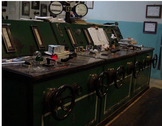
Figura 4. Porúas. Sala de máquinas.
